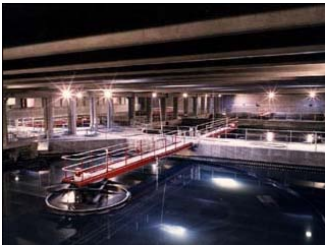
Réservoirs de l'usine de traitement des eaux usées de Winnipeg http://www.cbc.ca/manitoba/features/lakewinnipeg/wastewater.html
