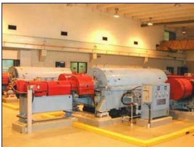
Centrifugeuse de l'usine de traitement des eaux de Winnipeg http://www.cbc.ca/manitoba/features/lakewinnipeg/wastewater.html
