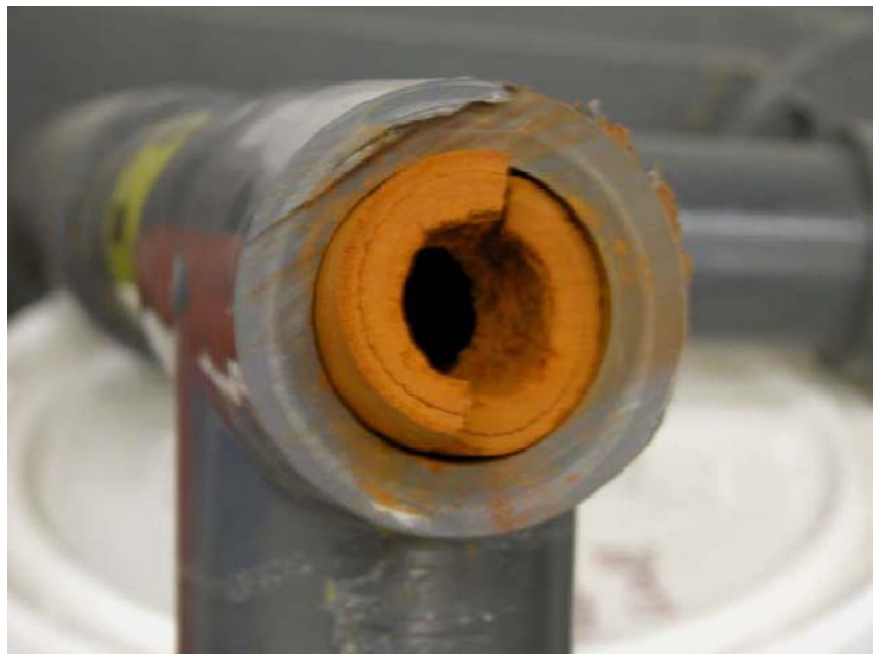
Photo 1 : Une couche épaisse de bactéries se forme dans une conduite d'eau
