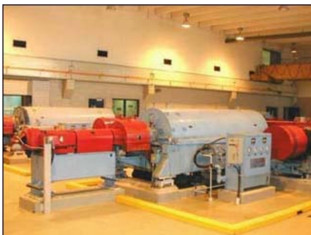
Centrifugeuse de l'usine de traitement des eaux de Winnipeg
