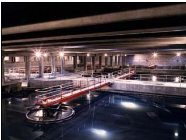
Réservoirs de l'usine de traitement des eaux usées de Winnipeg
